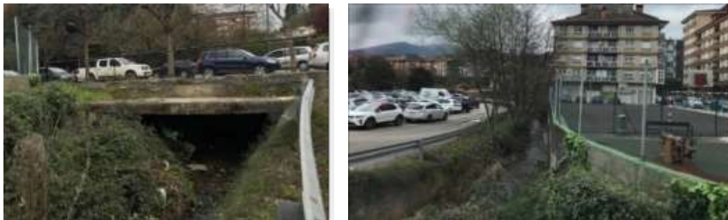
Fotografía nº1. Reducción de sección del arroyo San Juan aguas abajo de la avenida Zumalakarregi
