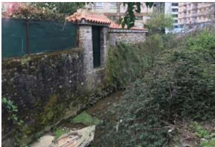
Fotografía nº3. Estado del arroyo San Juan pasada la zona urbana de la margen derecha
