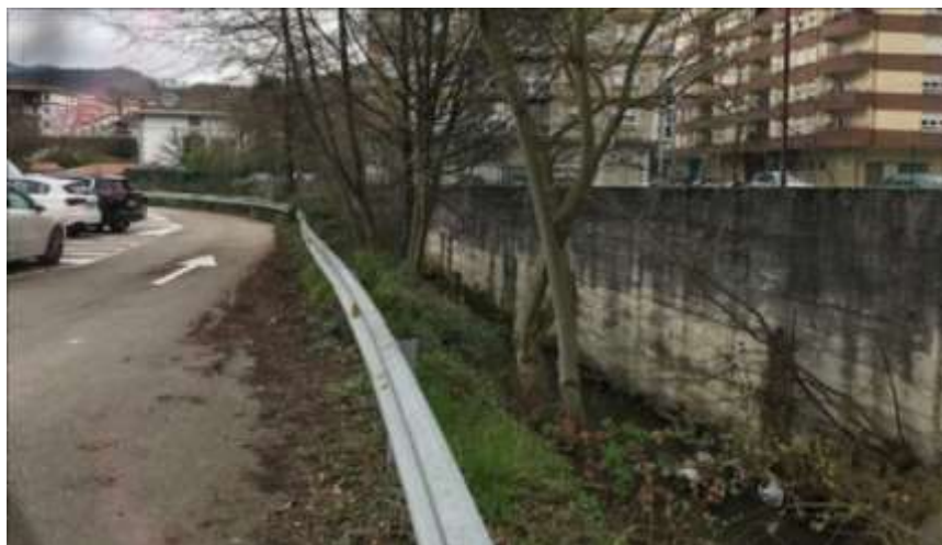
Fotografía nº2. Estado del arroyo San Juan a la altura del aparcamiento
